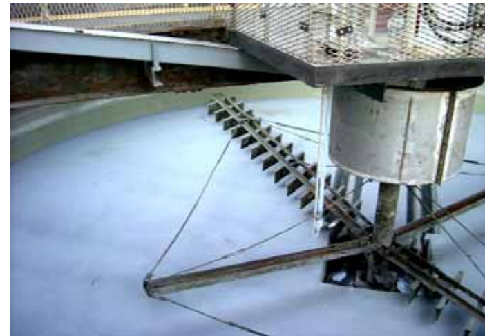
写真5 沈殿池の内面樹脂ライニングと 沈殿池底面すり鉢型化
