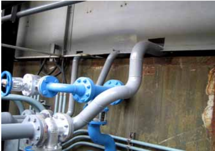
写真7 凝縮水の冷水槽への回収化
