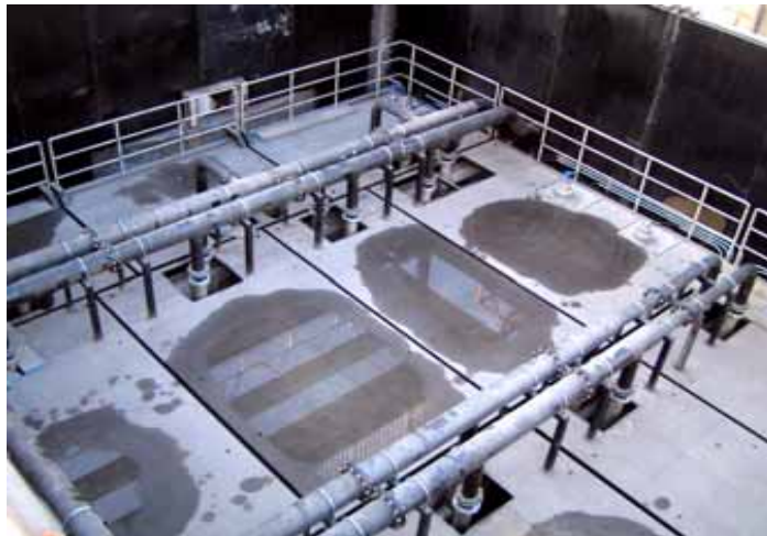
1-b. 温水槽、冷水層
