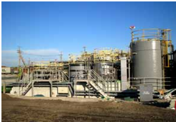
9-a シアン処理設備全景
