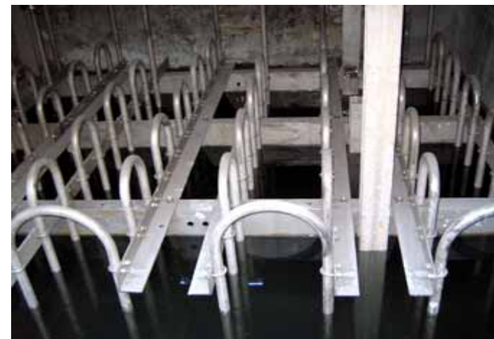
1-c. 槽内部の冷却配管と攪拌装置
