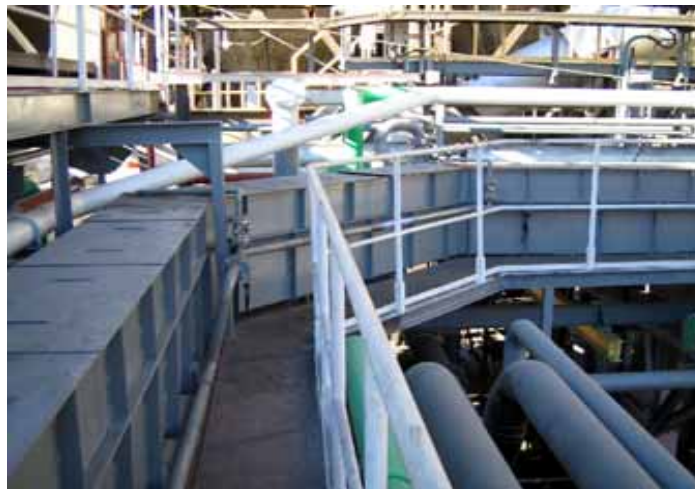
8-a 湿式除塵機排水トワノ高さ全景
