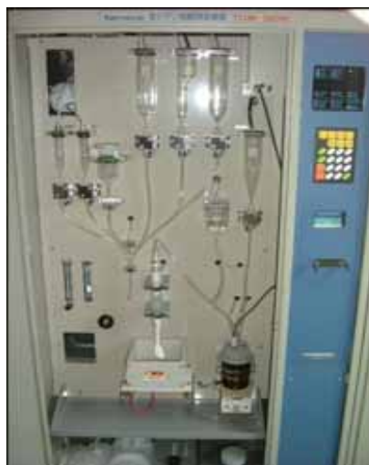
10-b. シアン濃度計(新沈殿槽出口)
