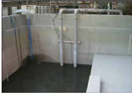
13-b. 貯留槽から水処理設備への送水
