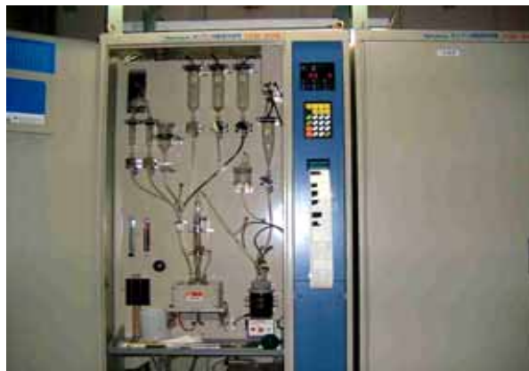
9-b シアン濃度計(水処理内)
